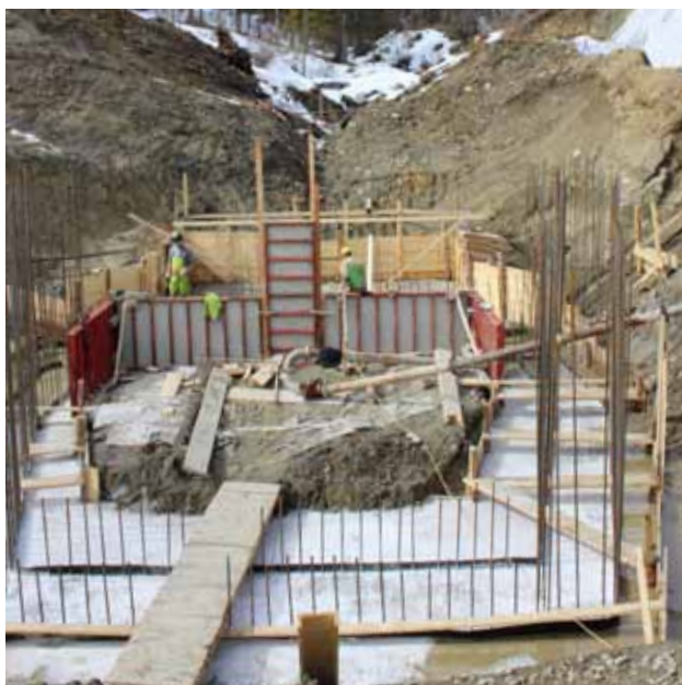
Die Arbeiten bei der Wildbachverbauung in Seitling sind seit Anfang des Jahres im vollen Gange.
